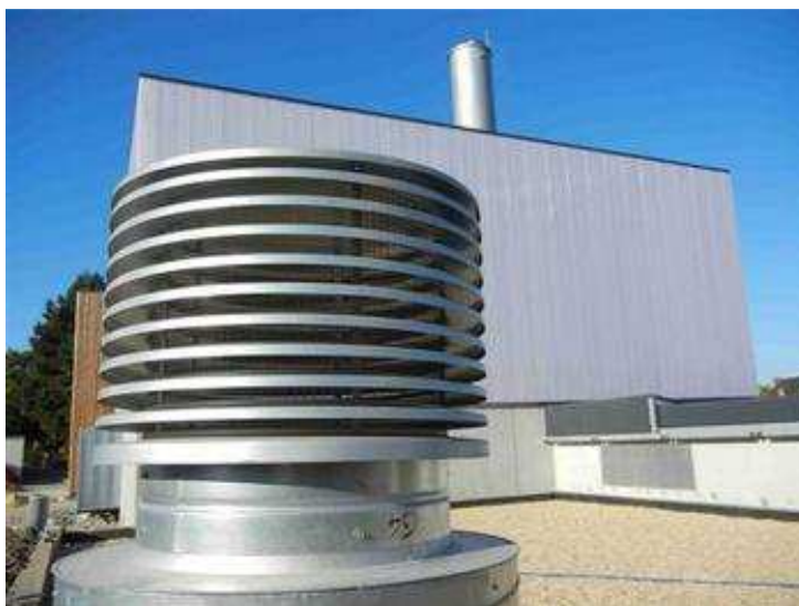
La chaufferie bois collective à Châteaubriant est raccordée à un réseau de chaleur de 9,5 km
